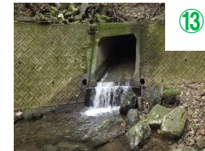
⑬ 【トンネル】 水量が多い日は足をとられやすい
